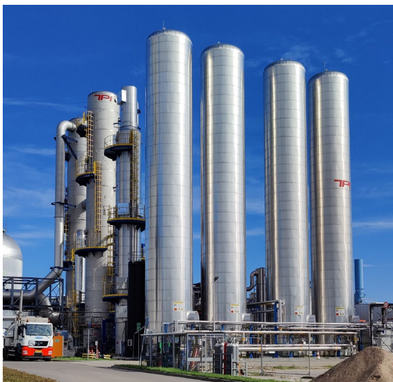
Abbildung 8-9: 300 m 3 CO 2 Speicher AVR Duiven (NL).
